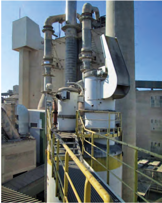
Bild 4: Abscheider mit Druckentlastungsklappe auf Pufferbehälter (AZO GmbH + Co. KG)
