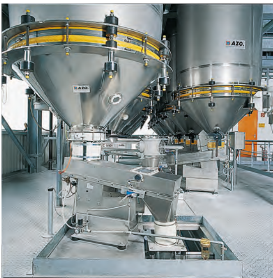
Bild 26: Siloentleerung über eine Vibrationsrinne (links: AZO GmbH + Co. KG)
