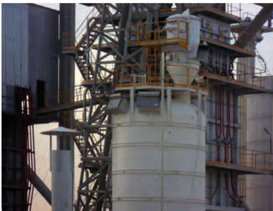
Bild 5: Silobefüllung über Zyklonabscheider mit seitlicher Explosionsdruckentlastung (AZO GmbH + Co. KG)
