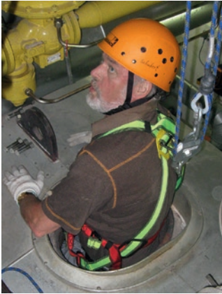
Mannloch eines Großraumdampfkessels
