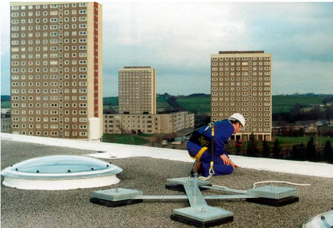
Bild 7: Beispiel für eine temporäre Anschlagereinrichtung auf Eigengewichtsbasis
